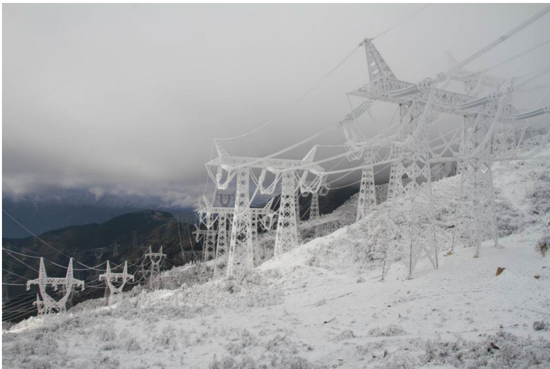
图 2 甘孜—天府南 1000kV 线路工程 60mm 特重冰区
